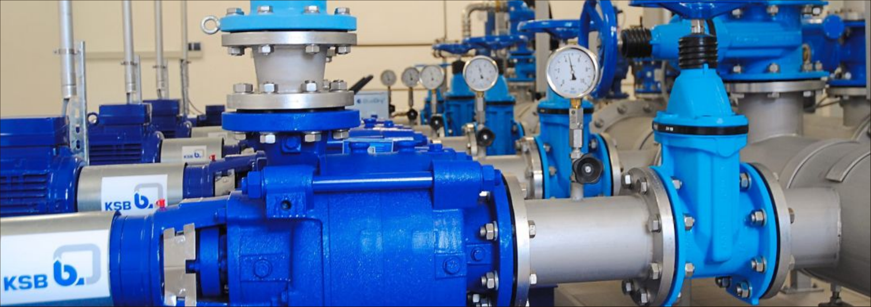
Hochleistungspumpen sorgen dafür, dass das Trinkwasser in das Versorgungsnetz des Marktes Ergoldsbach gepumpt wird.
